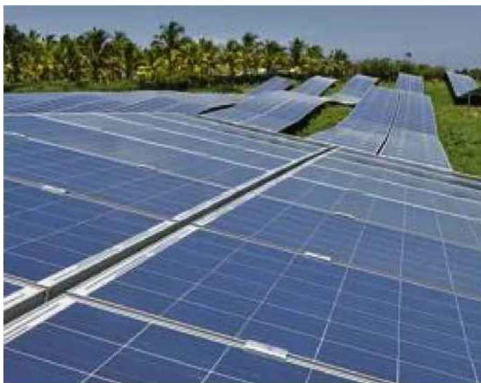
Ferme photovoltaïque au sol développée par Akuo à La Réunion.
