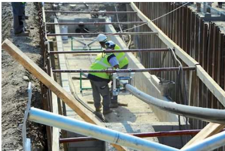
Un filet de sécurité pour l'électricité
