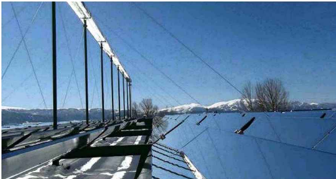
Parmi les nouvelles centrales retenues lors des appels d'offres, deux utilisent la technologie du solaire thermodynamique. Le projet porté par Solar Euromed en fait partie.
