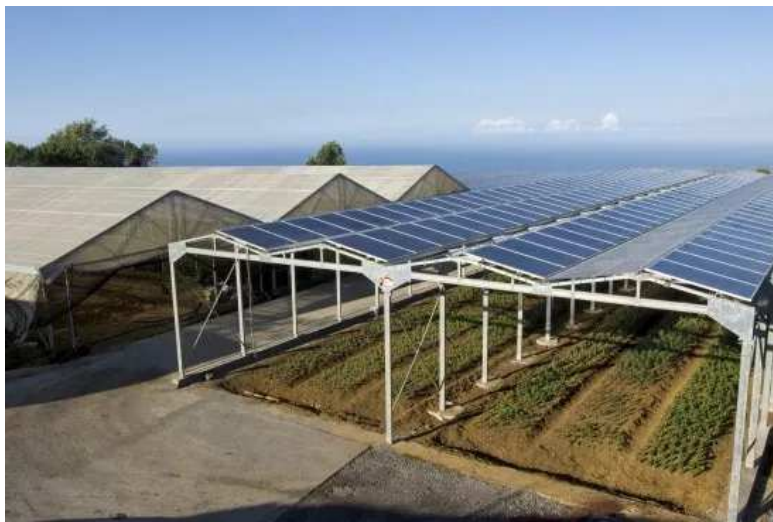
© Eric Legrand - La serre photovoltaïque du Tampon, à la Réunion, mise en service en janvier 2011.
