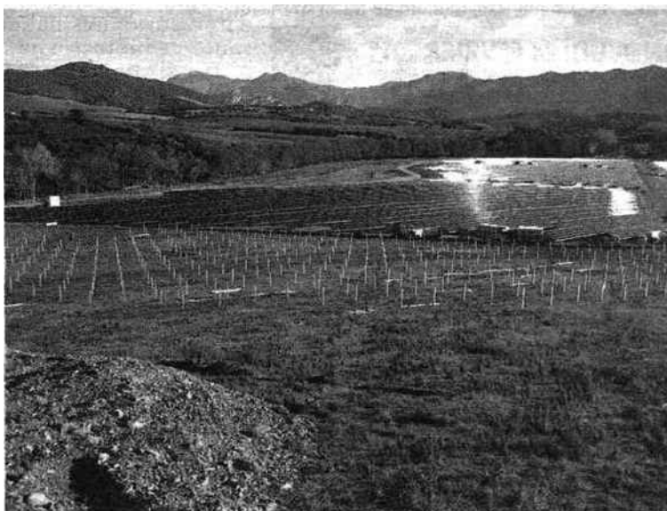
Site de la centrale de Rapale en Corse, aménagée par Akuo qui est similaire à celui de Saint-Auban.
