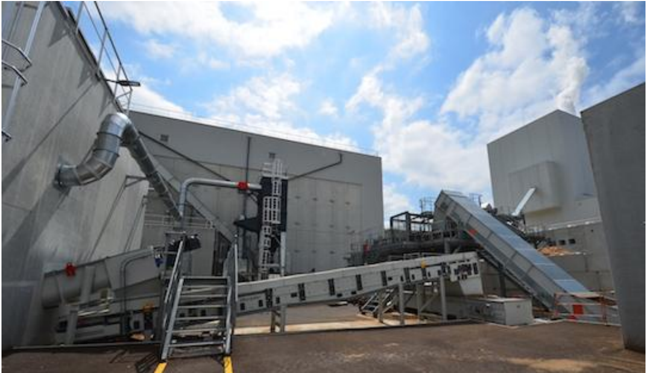
Convoyeurs VECOPLAN en sortie de local de broyage vers le poste de criblage avant la chaufferie, photo Frédéric Douard
