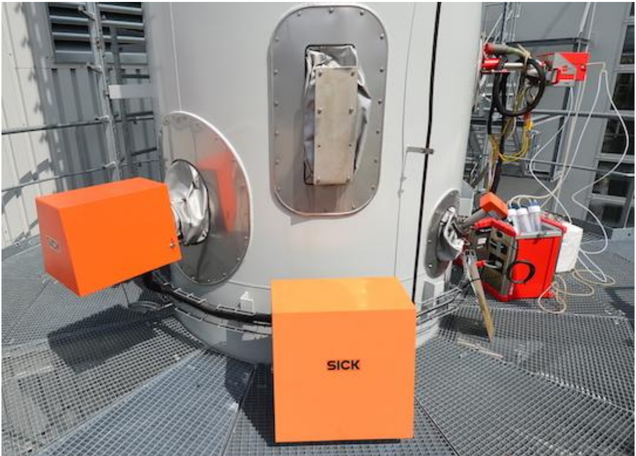
Appareillage de mesure en continu des émissions atmosphériques, photo Frédéric Douard
