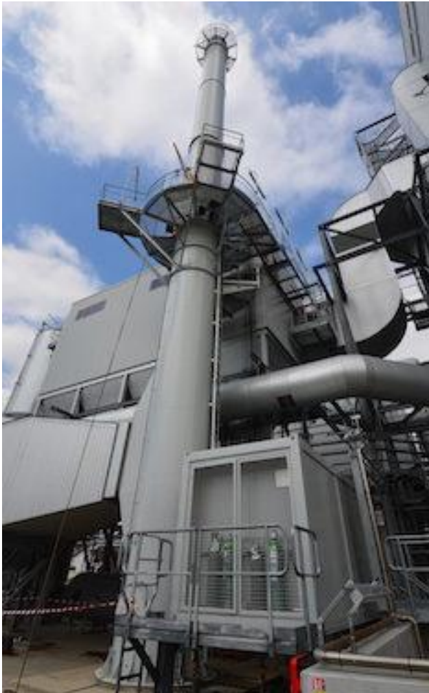
La cheminée de BCN et son filtre à manches, photo Frédéric Douard
